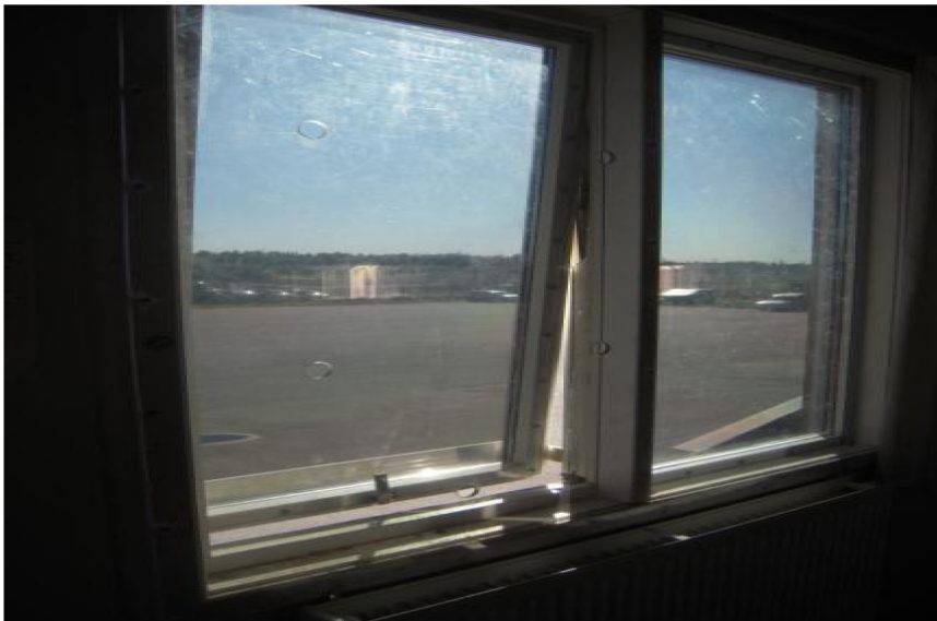
Vindu med pleksiglass og luftehull
