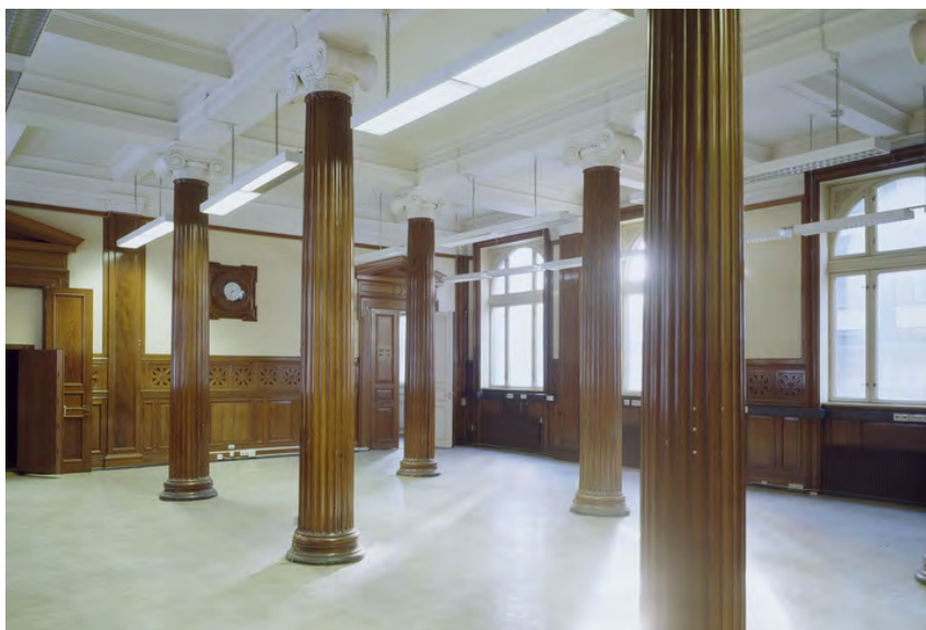
Ekspedisjonshallen før rehabiliteringen. Under gulvbelegget er det marokkanske fliser, og i takene er det avdekket takmalerier. Foto: Jiri Havran. Opphavsrett: Statsbygg.
