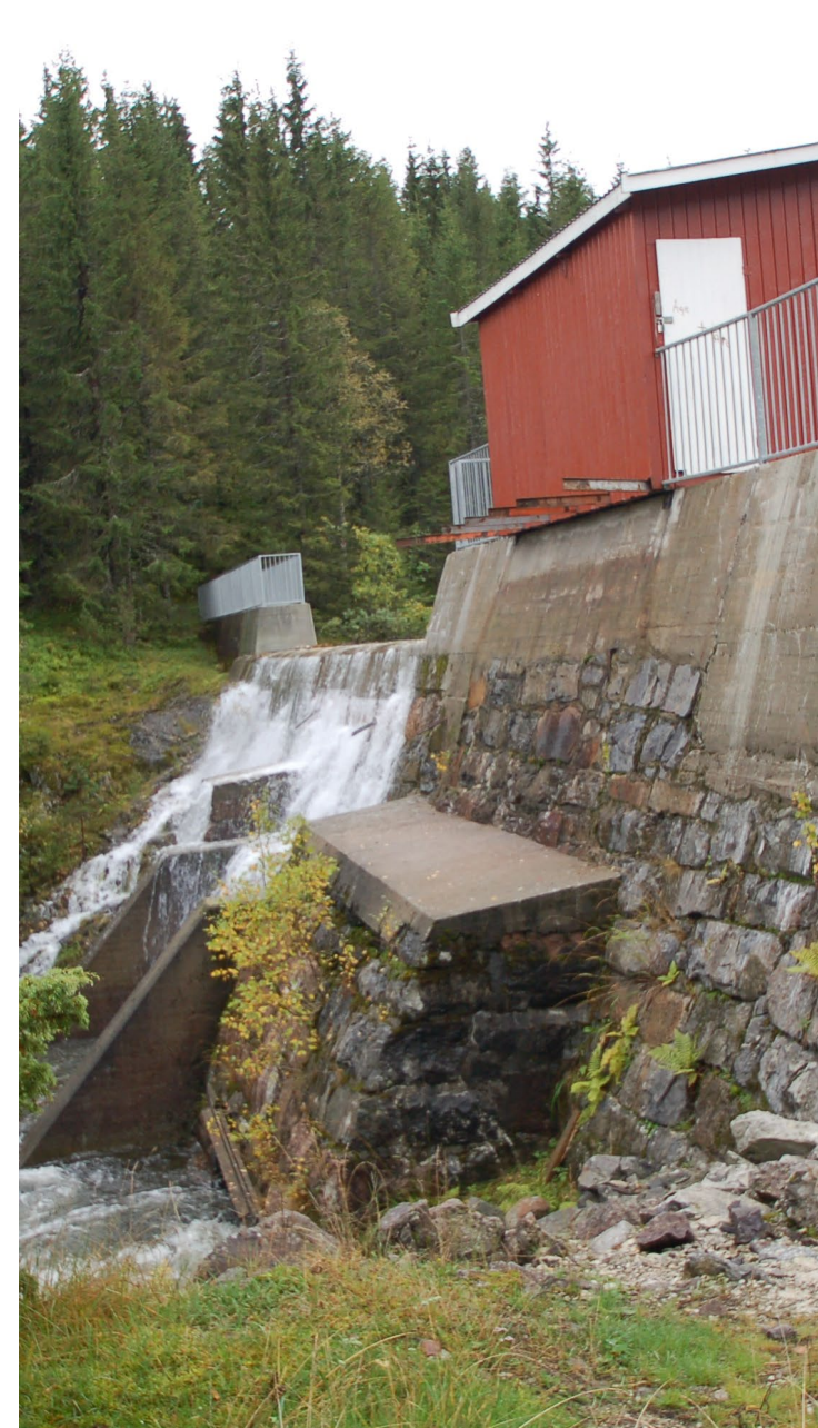
Foto: Glitre vannverk
