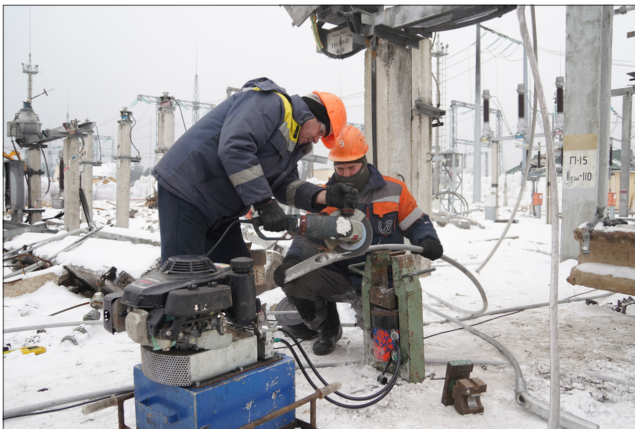
Figur 5.3 Norge bidrar med betydelig støtte til energisektoren i Ukraina. Deriblant reparasjoner på anlegg til det statlige elektrisitetselskapet Ukrenergo, som er hardt utsatt for russiske angrep.
