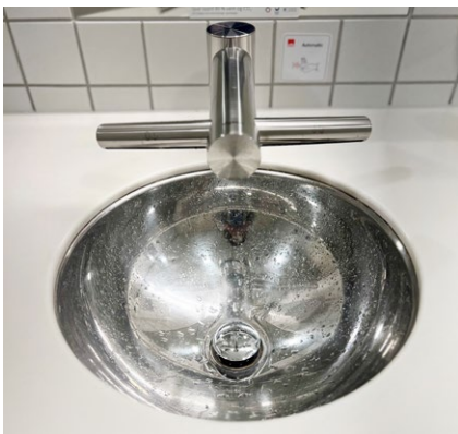
Bilde: Installasjon armatur med vask- og håndtørketeknologi
