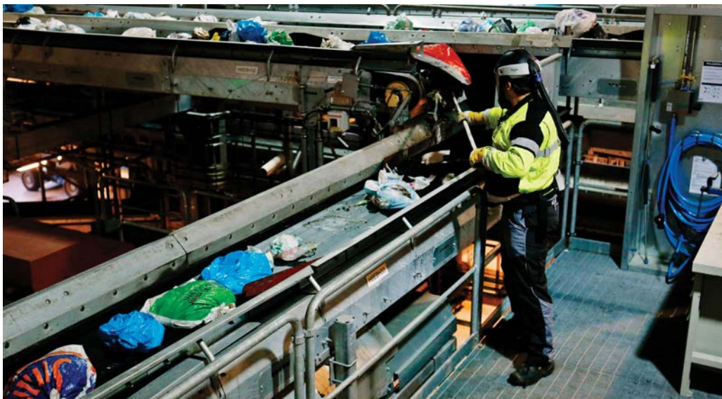
Haraldrud energiattvinningsanlegg er eit av to attvinningsanlegg for avfall i Oslo. Ved anlegget blir hovudsakleg hushaldsavfall, og noko næringsavfall behandla - totalt ca. 100 000 tonn i året. Foto: Erlend Aas
