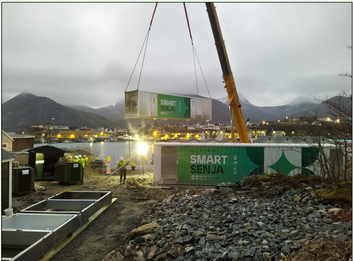
Figur 5.2 Noregs største batteri vart heist på plass på Husøy i november 2021.
