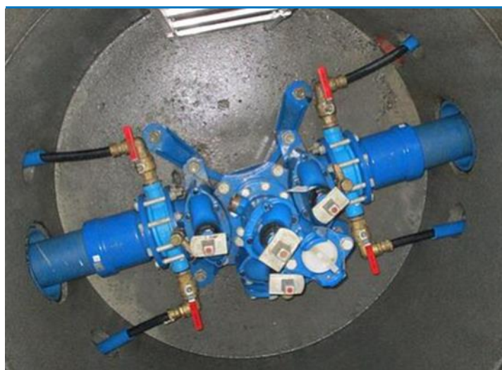
Figur 3-25: Bilde av vannkum med stikkledningstilknytninger
