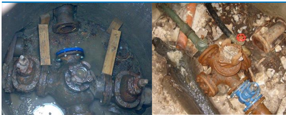
Figur 3-26: Bildet til venstre viser en vannkum og bildet til høyre en felleskum for vann og avløp
