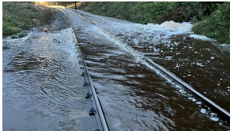
Oversvømmelse på Bergensbanen etter «Hans». Foto: Bane NOR
