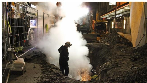
JOBBER PÅ SPRENG: Det var her i Akersgata at et arbeidsuhell førte til trykktall i fjernvarmenettet. Nå jobbes det hardt for å få utbedret feilen. FOTO: KJETIL GRUDE FLEKKØY / NRK
