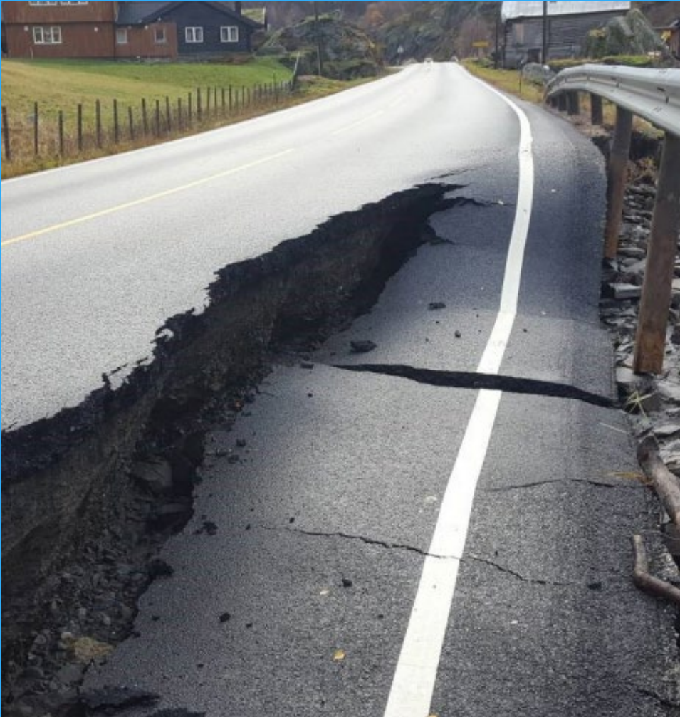
Flomskader Fylkesvei 55, Lom
