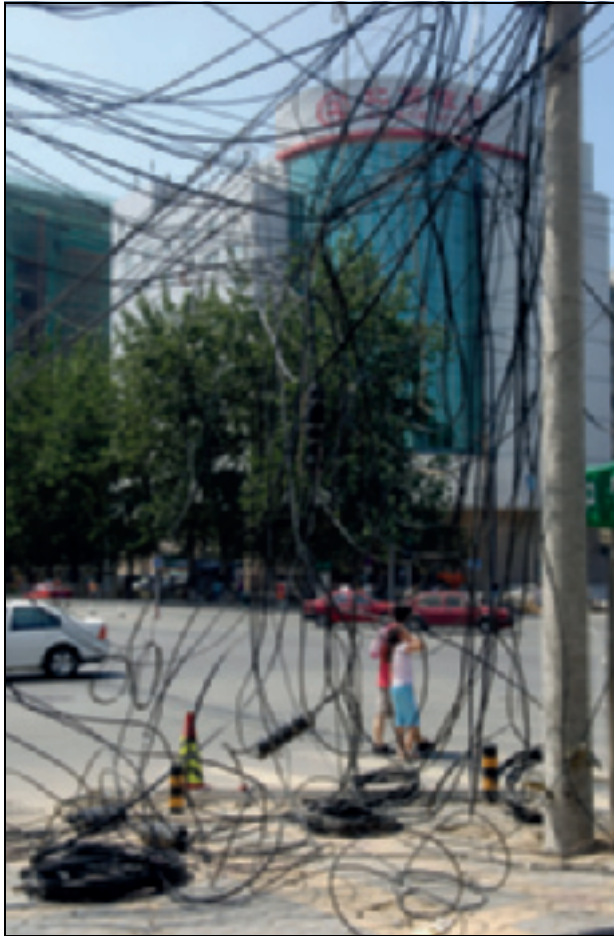
Figur 4.5 Strømforsyning kan være flokete arbeid. Foto: ILO
