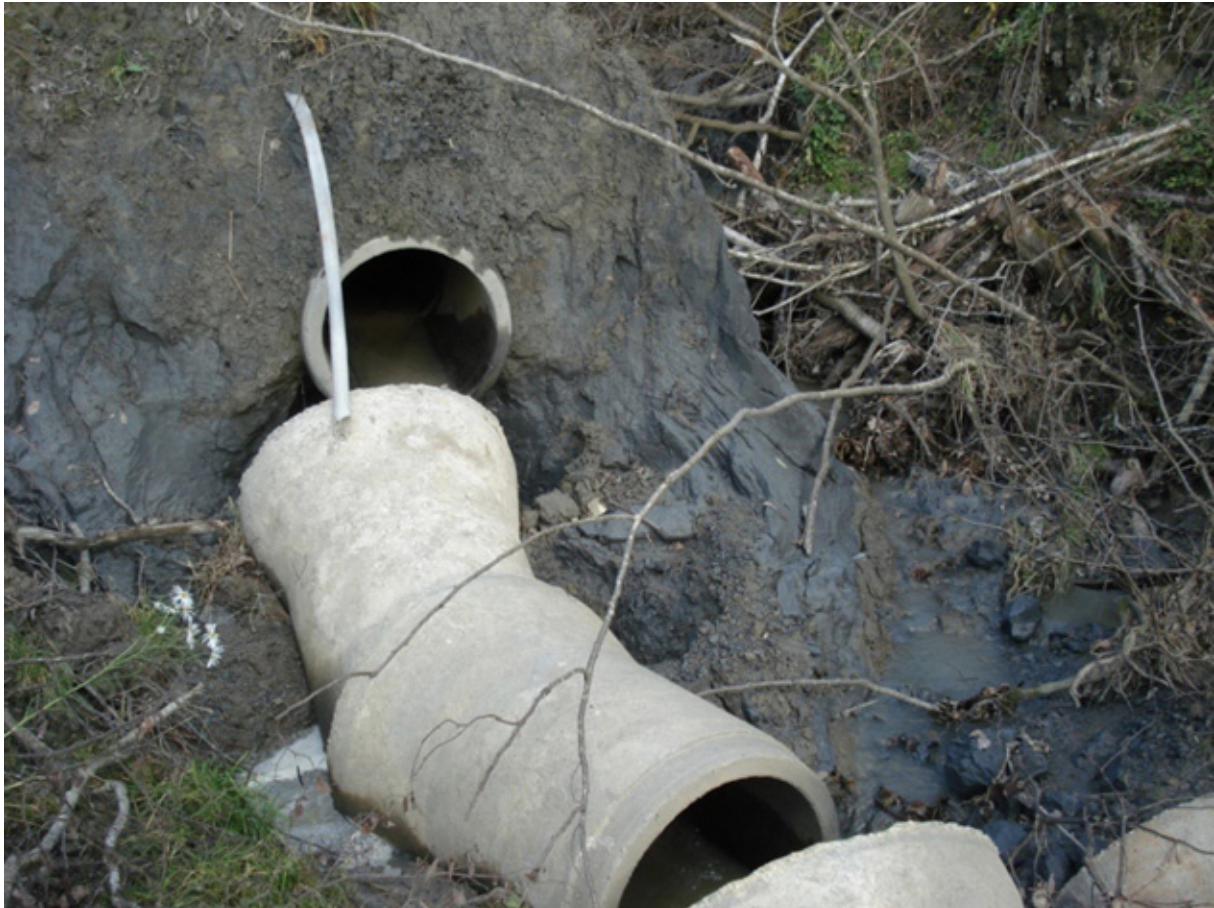
Figur 9.2 Bilde fra Asplan Viak-rapport, med bildeteksten «Utglijning av leirmasser i bekkeløp i felt I med OV-rørkollaps. Bekken graver direkte i leire.» (Asplan Viak, 2009).
