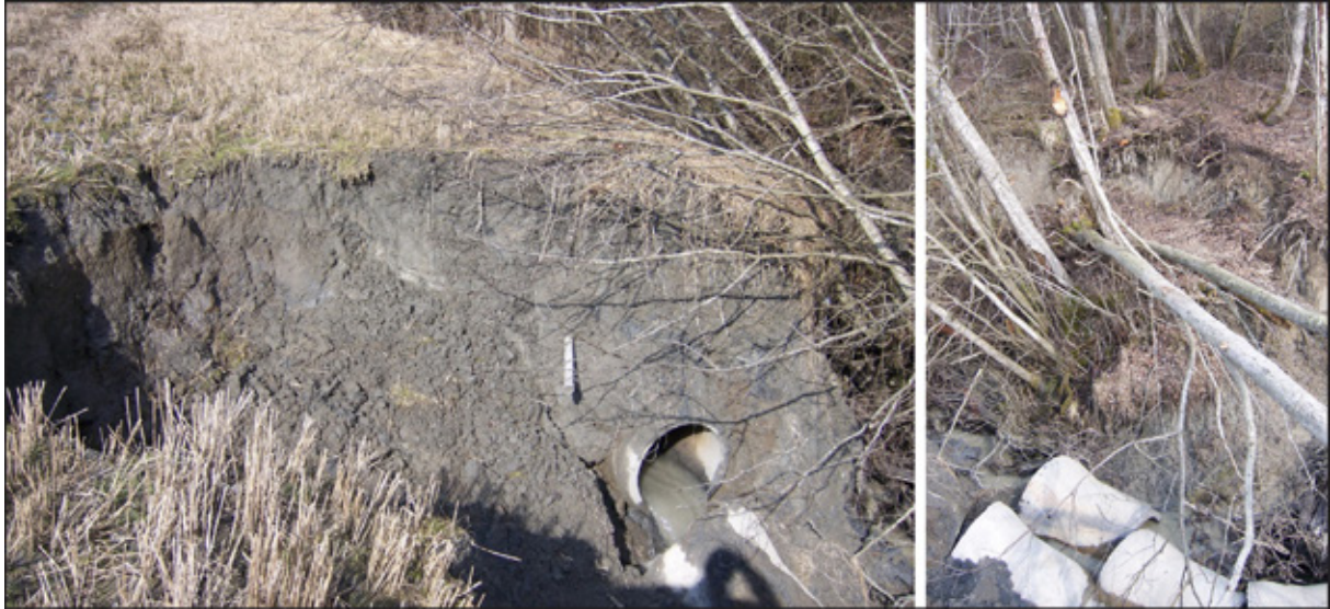
Figur 7.2 Tistilbekken ble lukket i 1986, men brøt seg senere ut av rørene. Bildene er tatt på samme sted som bildene A og B i figur 6.8. Foto S. Myrabø, tatt i 2008.
