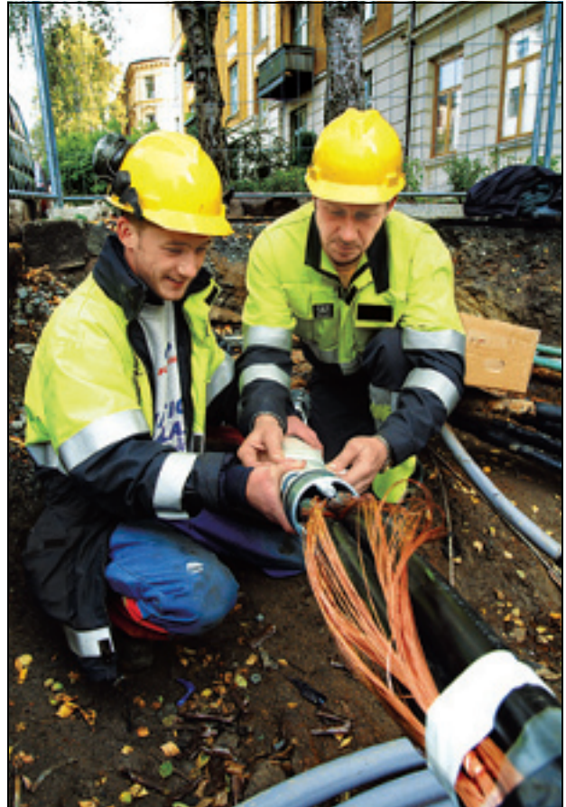
Figur 6.12 Kabellegging på 22 kV
