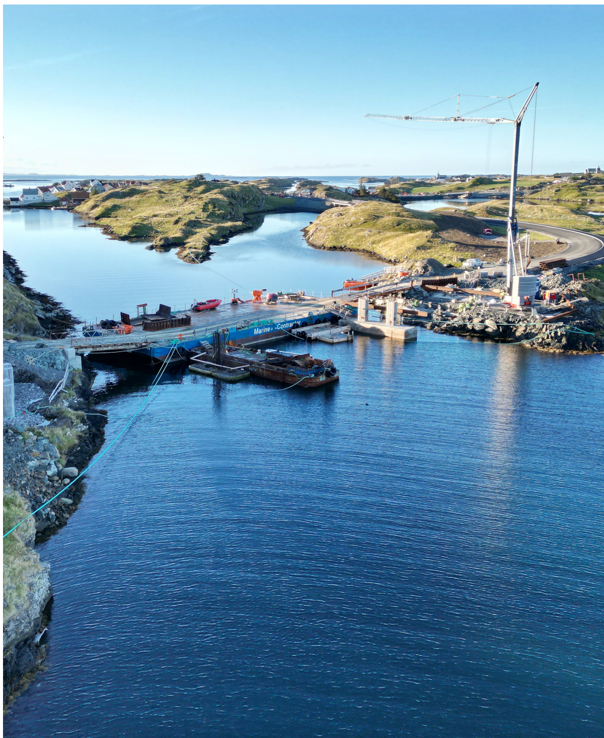
Bilde fra Kvitsøy, som blir landfast i forbindelse med byggingen av Rogfast. Foto: Øyvind Ellingsen, Statens vegvesen
